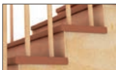
Balaustros caen a los peldaños.
